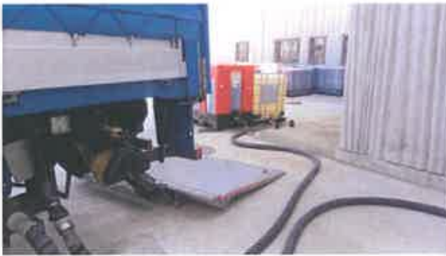
2023-08-31 Fin d'été dynamique sur Fabrègues avec aujourd'hui le remplissage de la cuve de chlorure suite à la fuite côté aspiration
