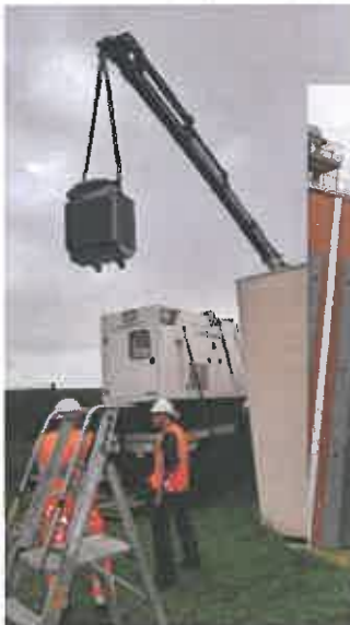
2023-10-Le 23 octobre nouveau transfo. Fiabilité et performance énergétique
