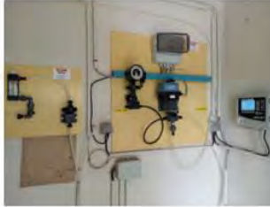
Fabrègues → renouvellement de la pompe lait de chaux pour les boues 09/2021
