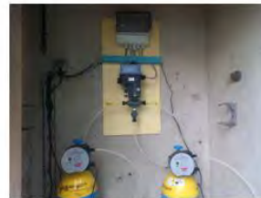
chloration remise à neuf après la saison
